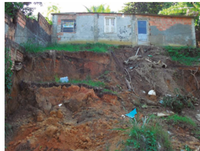
Figura 8: Casa atingida por deslizamento planar induzido por ocupação humana na Estrada do Zumbi, no bairro de mesmo nome. Fonte: Cátia Tavares, 2010.
